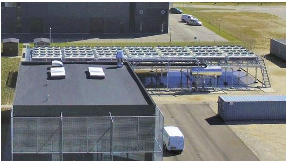
Grenå fjernvarme (4,5 MW). Maskinbygning og energioptager.
