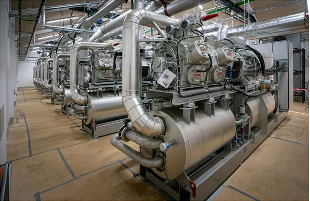
Varmepumper. Horsens Fjernvarme (samlet kapacitet: 12 MW).
