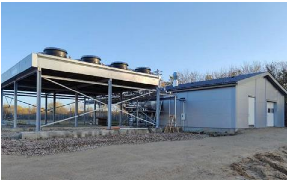
Saltum Fjernvarme (1,2 MW). Maskinbygning og energioptager.
